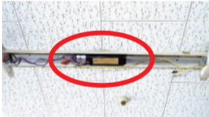
蛍光灯安定器の設置例
