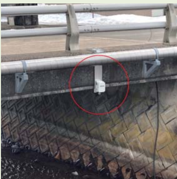
危機管理型水位計の設置状況(赤丸内)
