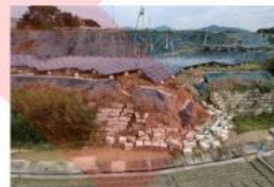
法面保護工が崩れて流出した事例
