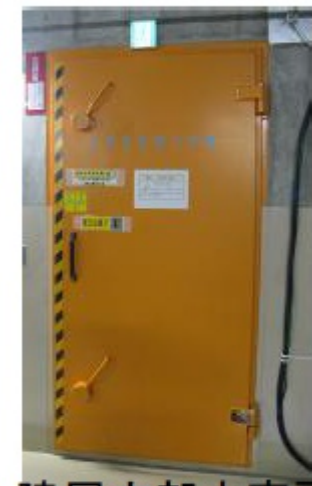
建屋内部水密扉
