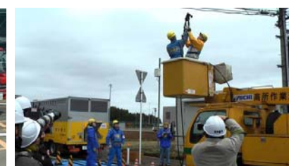
電源車を用いた電源確保訓練
