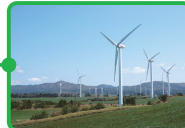
■六ヶ所村二又風力発電所(六ヶ所村)
