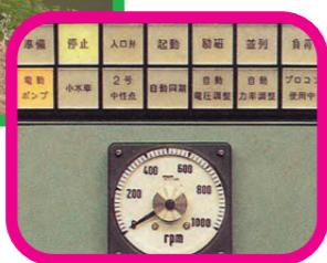
★ダムの水不足で発電停止中
