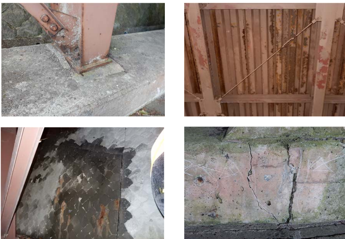
図-6 損傷状況の一例
