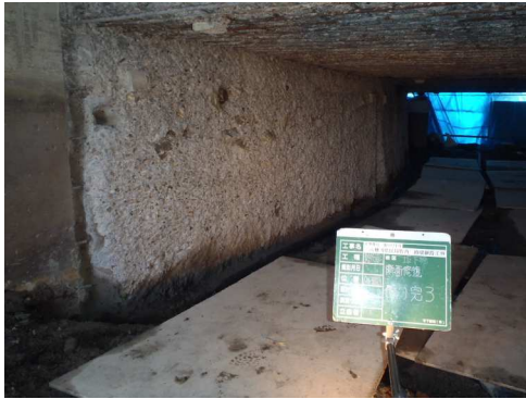
八戸野辺地線 坂下橋【補修前】
