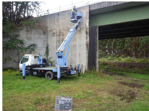
国道279号 第二跨線橋 (アルカリ骨材反応の追跡調査・秋)
