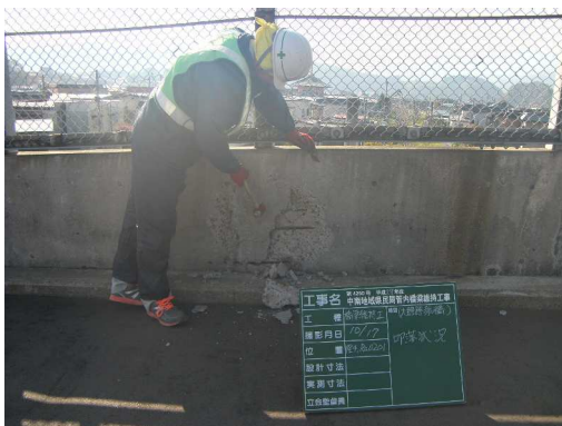
中南地域整備部緊急措置（叩落し）
