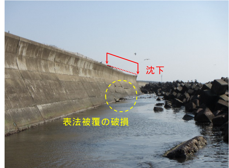
脇元海岸(五所川原市) 被災状況 - 護岸(表法面)の状況 -
