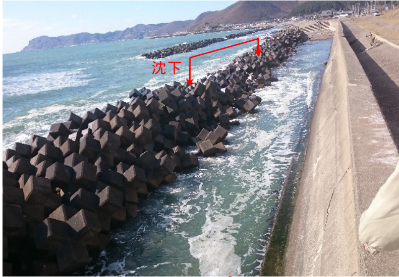
脇元海岸(五所川原市) 被災状況 - 消堤波の沈下状況 -
