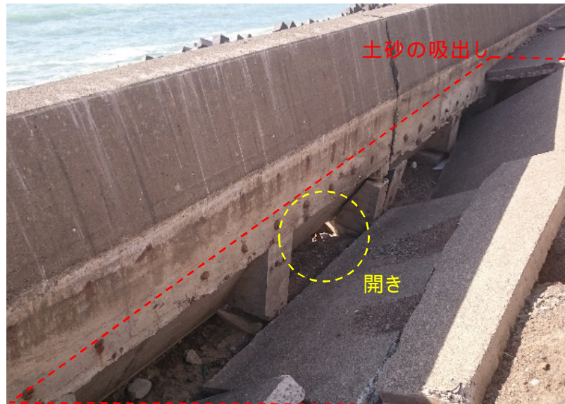
脇元海岸(五所川原市) 被災状況 - 天端工の沈下・陥没状況 -
