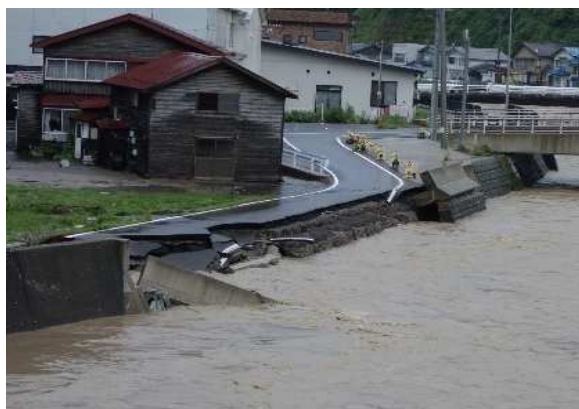
護岸の被災状況
