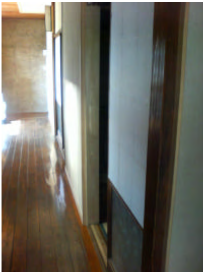
構造用合板使用により壁チリが厚くなった
