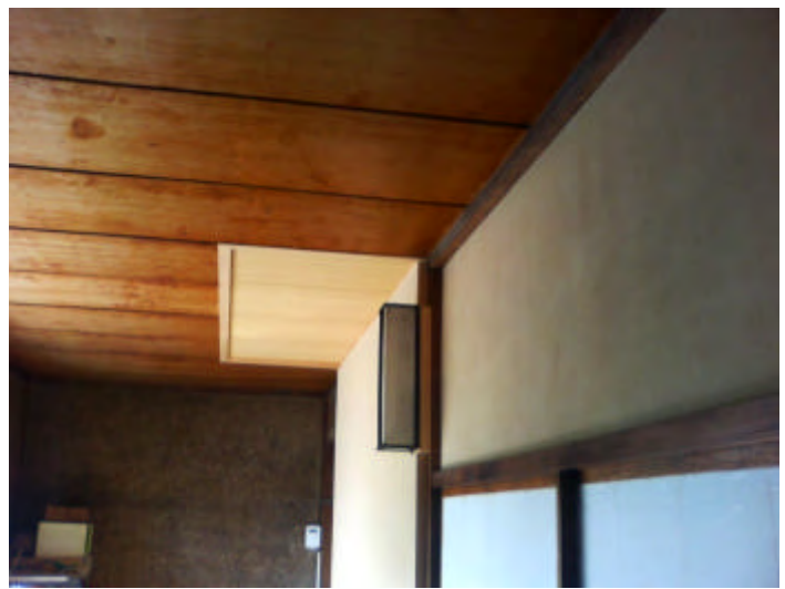
小屋裏までの補強のため、天井に開口を設け、新材で補修
