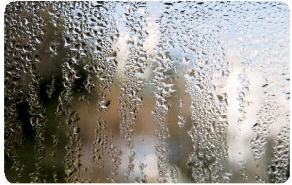
結露 寒い時期に多く見られる。
