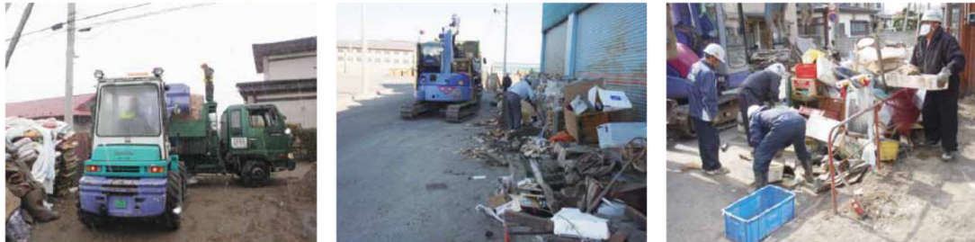
人力のみでは対応困難な場所が多かったため、重機・ダンプ等を用いて作業を行った。
