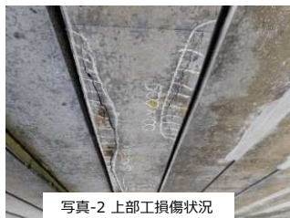
写真-2 上部工損傷状況
