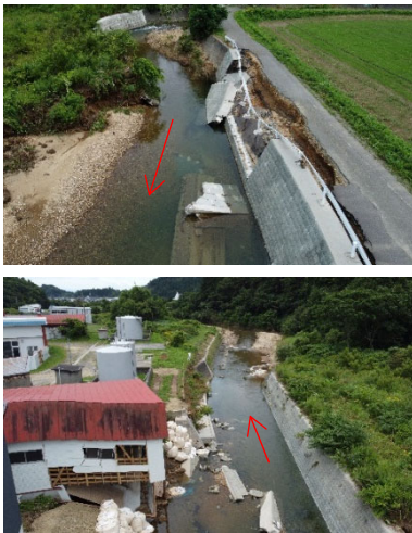
被災状況写真
