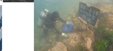
施工範囲内の水生生物の生息状況を調査・記録のうえ保護対策を立案し貝類やアマモ等の移植を実施
