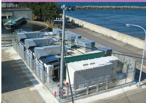
消化ガス発電設備全景
