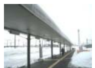
城東口広場歩道融雪状況
