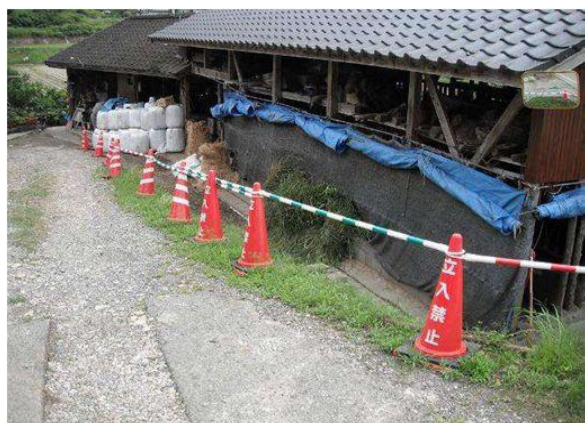
工事中カラーコーンを用い境界を設置した事例【牛農場】
