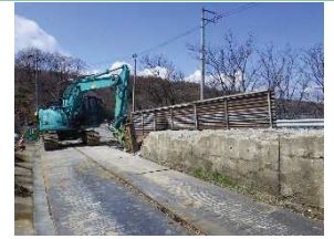
飛び石防護柵
