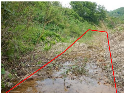
【着工前】 水はけが悪く湿地状態
