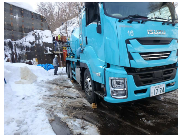
生コン車逸走防止(車止め)
