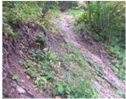
崩落した歩道斜面
