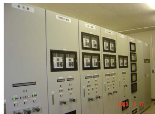
(ME化後の変電所設備)
