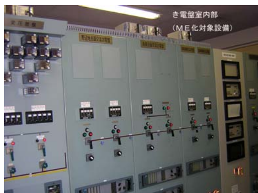
(ME化前の変電所設備)
