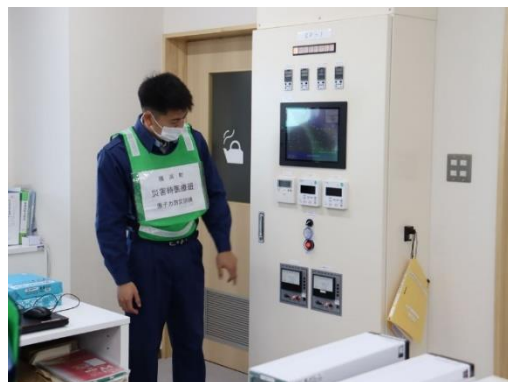
【放射線防護設備稼働】
