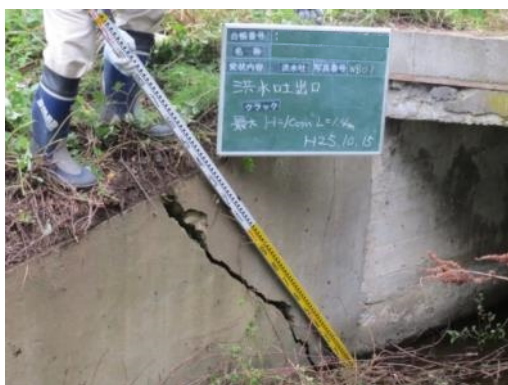
洪水吐側壁ひび割れの例
