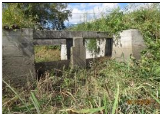
洪水吐に土砂が堆積し植物が繁茂している例
