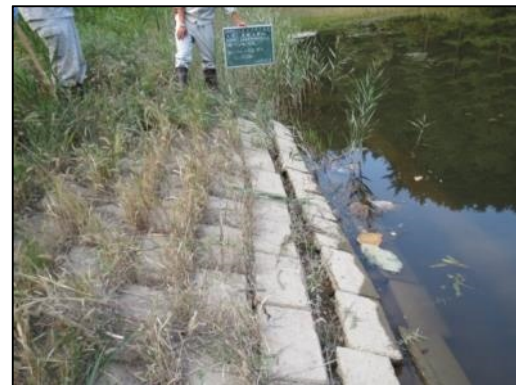
堤体が沈下し護岸ブロックが変形している例
