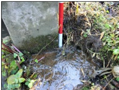
底樋出口の脇から漏水している例
