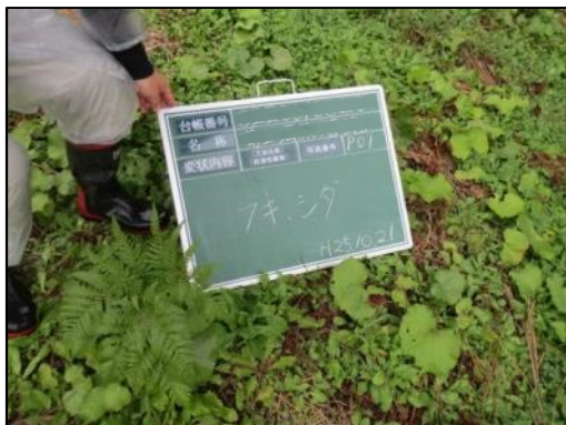
下流法面にシダが繁茂している例
