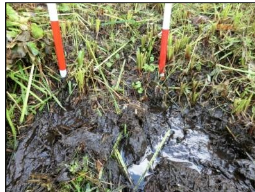
堤体下流法面から漏水している例
