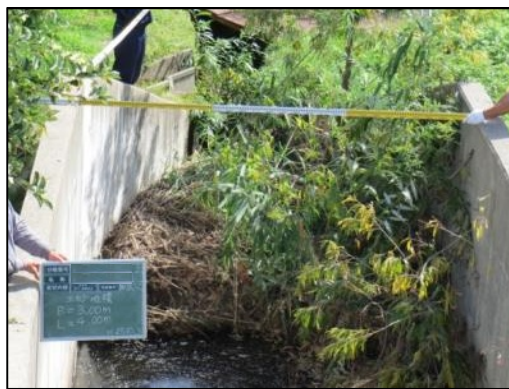
洪水吐部の土砂堆積（通水阻害）の状況
