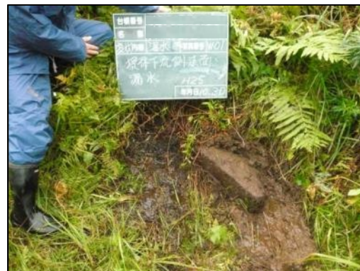
シダ繁茂部から漏水が生じている例
