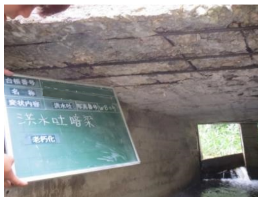
洪水吐部コンクリート鉄筋露出の例
