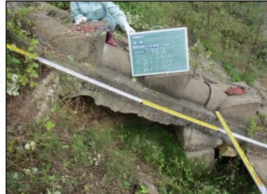
斜樋と堤体の間に隙間が生じている
