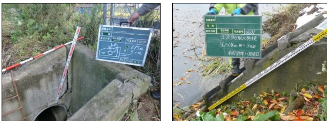
取水施設に見られるひび割れの例
