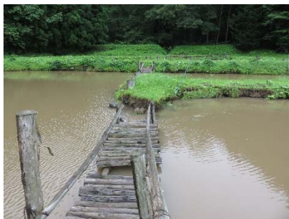
経年劣化したビオトープ池
