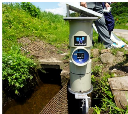
【自動給水栓を活用した実証試験】
