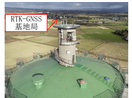
【板柳町基地局(高架配水塔上部)】
