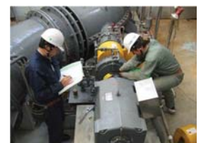
老朽化したポンプの機能診断
