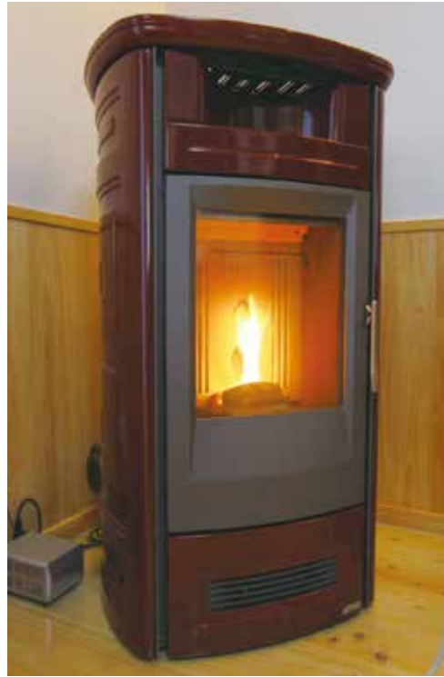
木質バイオマスの炎が自然素材の空間に柔らかくマッチ
