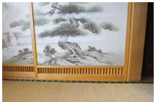
結露防止のために、押入れの襖戸の下に設けられた換気口
