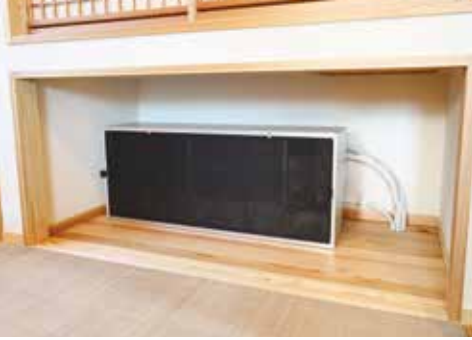
家の中の冷暖房はこのエアコン1台でまかなえる
