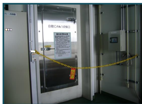
ラック式りんごCA貯蔵庫の点検口
