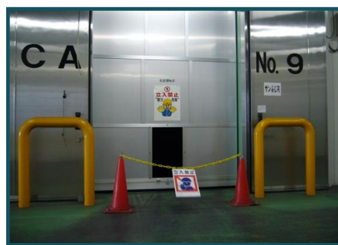
りんごCA貯蔵庫内扉を開ける時は立入禁止
