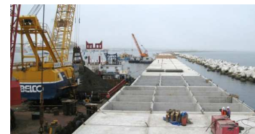
北防波堤の被災状況と復旧状況
