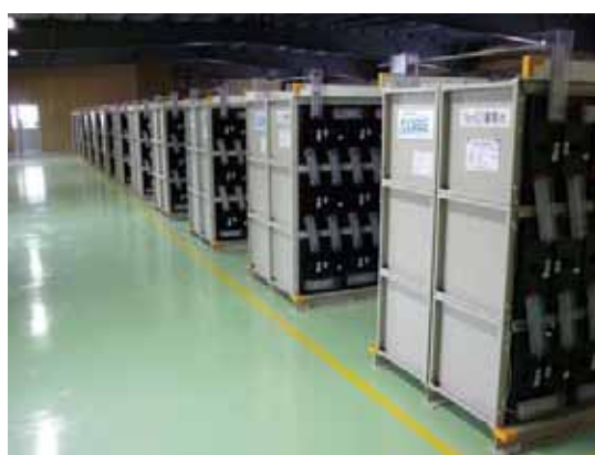
図2-7 市浦風力発電所長寿命鉛蓄電池(LL-W電池)外観
