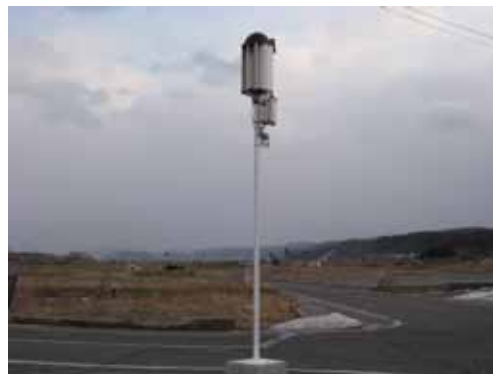
図2-11 岩手県野田村に設置された誘導灯小型風力発電機
