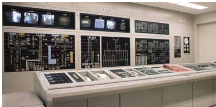
図2-30 ビル管理システム監視装置
