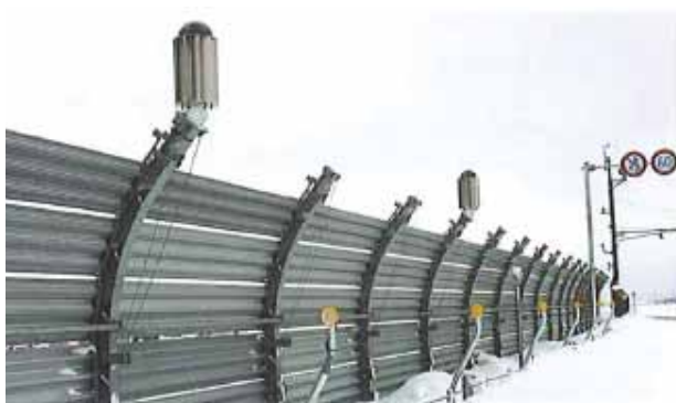
図2-10 地吹雪誘導灯向けの小型風力発電機
