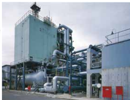
図3-14 冷熱発電プラント
