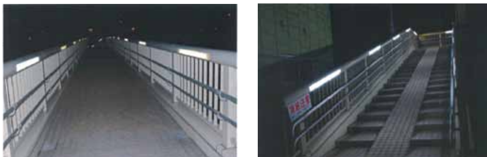
図 2-27 LED 照明設置例(八戸合同庁舎歩道橋)
