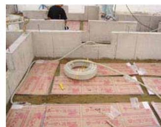
図2-21 ヒーターパネル施工例
