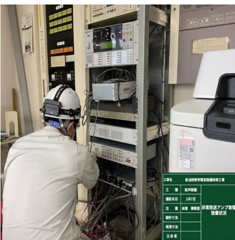
拡声設備及び自動火災報知設備
