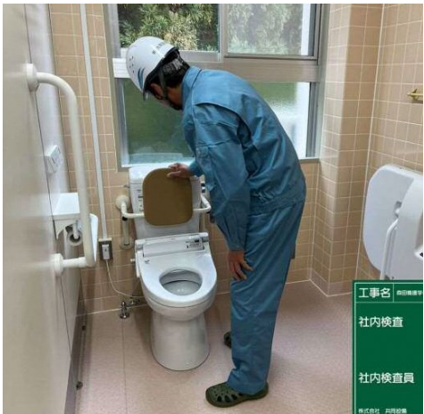
2階WC 衛生器具
