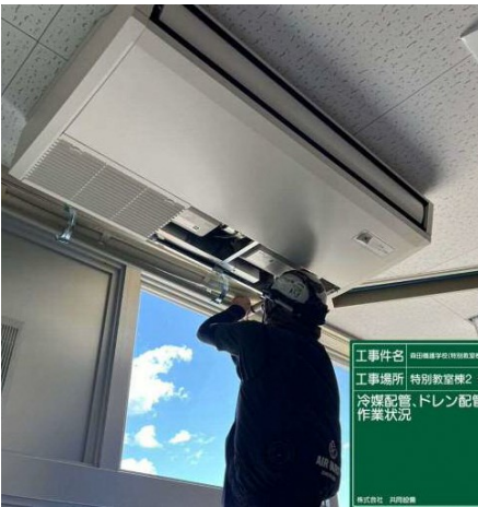
エアコン室内機
