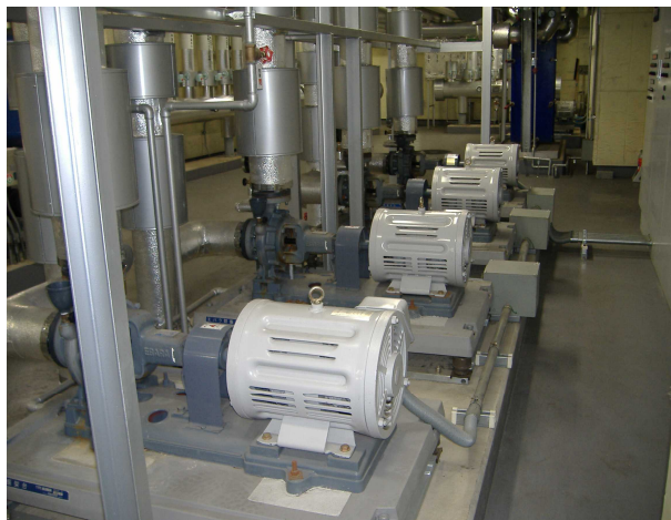
ポンプが複数台に分けて設置されている
