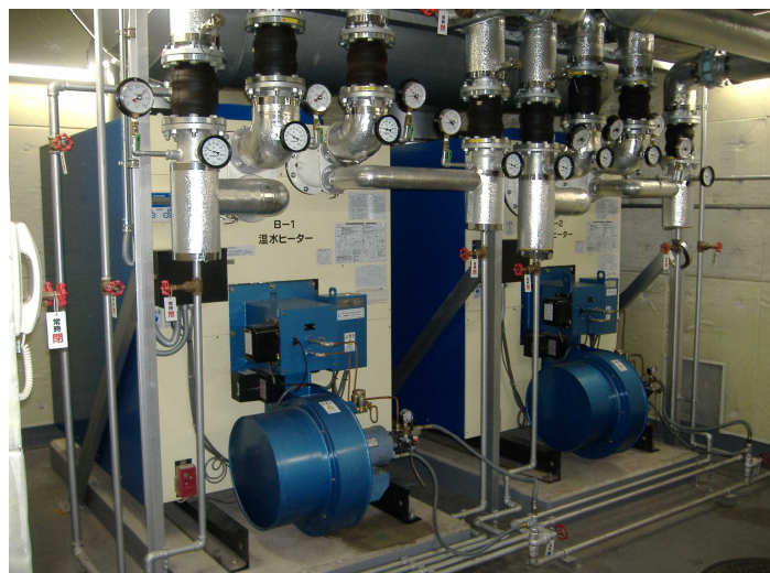
ボイラーは故障などに備え複数台に分けて設置されることが多い
