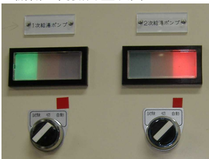
機械室内動力盤表面
